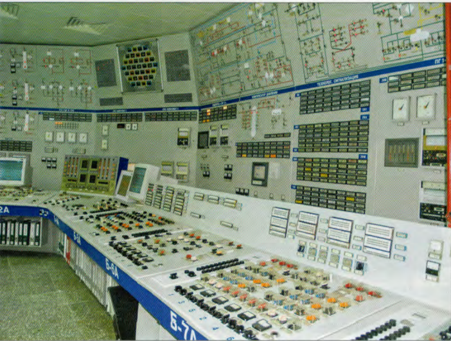
Блочный щит управления энергоблока 2 Ривненской АЭС после модернизации, выполненной с участием НПП «Радий» в 2008 г.
